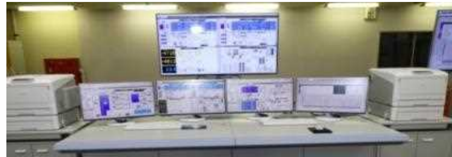
【更新した監視制御盤】
