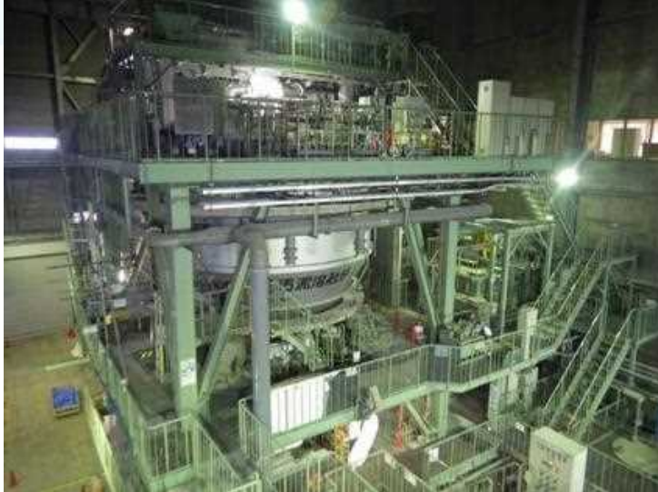
二上浄化センター3号汚泥溶融炉
