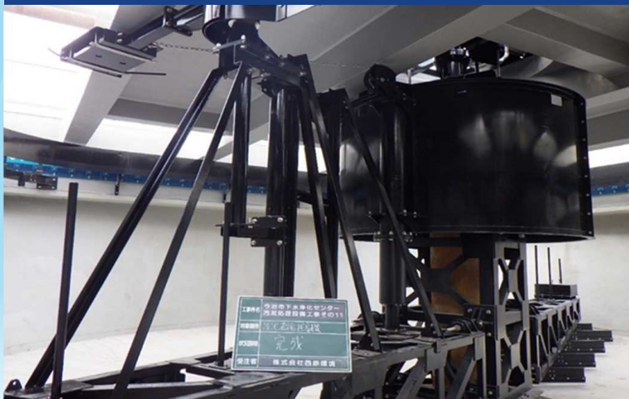
濃縮汚泥掻寄機
